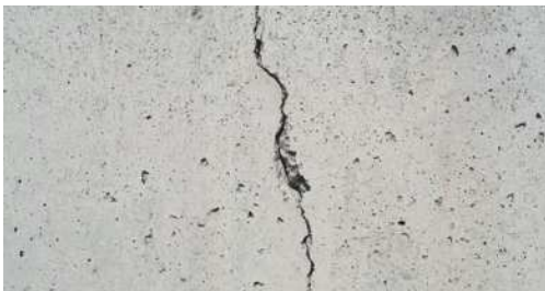
ひび割れ発生
